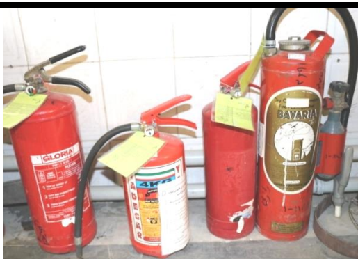
کپسول های آتش نشانی
